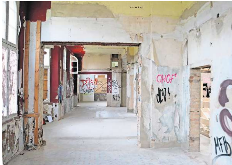
Blick in die erste Etage der Villa Baltic: Das Gebäude muss dringend saniert werden.
