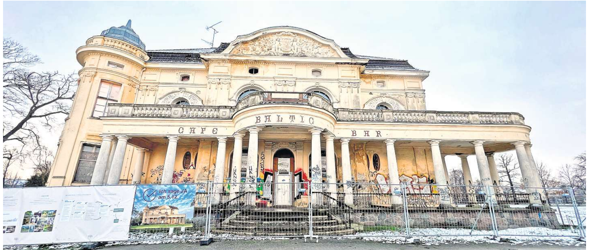
Die verfallene Villa Baltic in Kühlungsborn West. Über ihr mögliches Schicksal konnten die Kühlungsborner am Sonntag beim Bürgerentscheid mitbestimmen. FOTO: LENNART PLOTTKE
